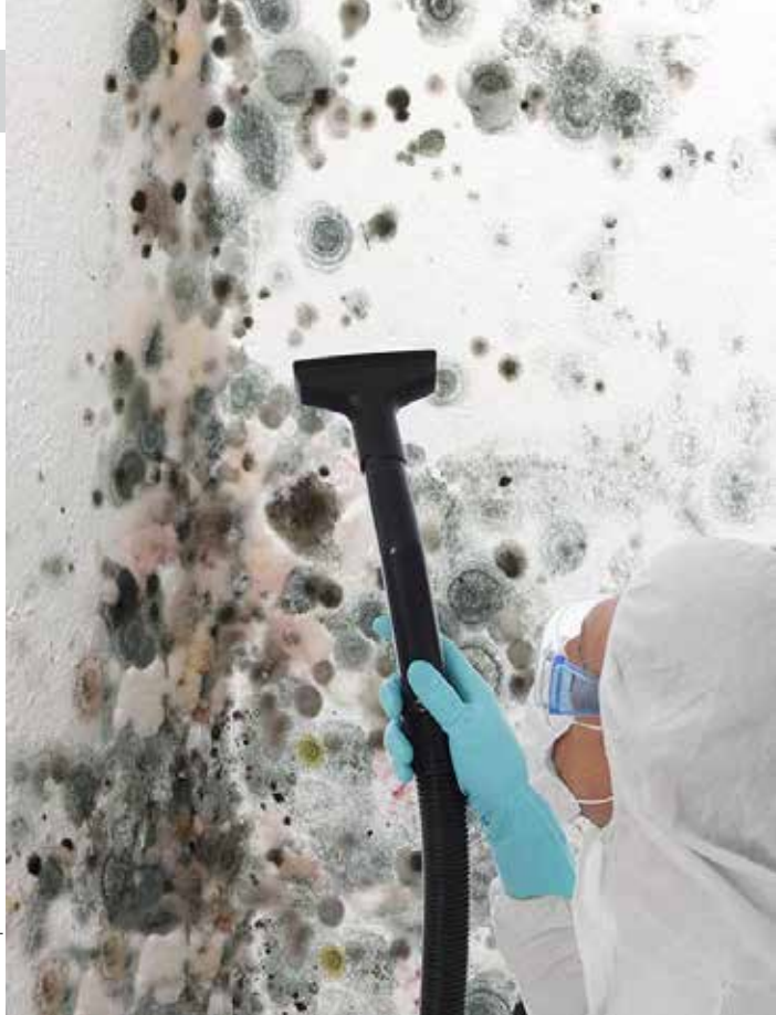
Homeen vaurioittama materiaali tulisi aina ensin poistaa mekaanisesti ja vain erityistilanteissa tehostaa käsittelyä desinfiointilla. Erityistilanteita ovat esimerkiksi hajuhaitan vähentäminen ja viemäri vahinko.
